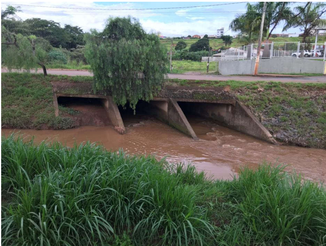
Figura 7 – Foto do desemboque do Córrego Canavial no Ribeirão da Fábrica – Bueiro assoreado
