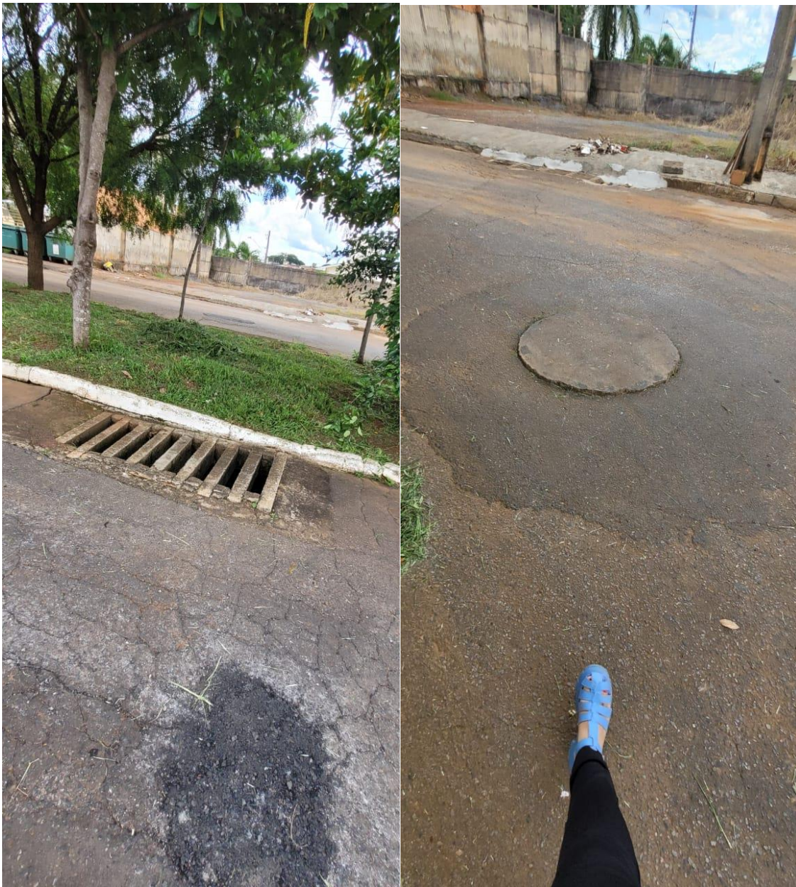
Registro da rede na Avenida Francisco de Paula Ferreira
